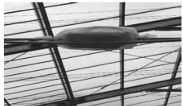
写真4 ハウス内上部に設置されているミスト装置
